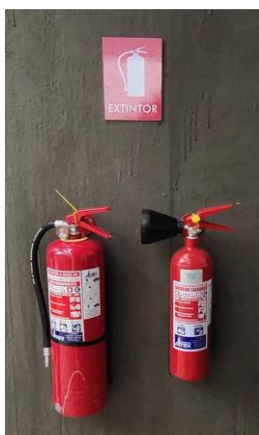
EXTINTOR PQS Y CO2
