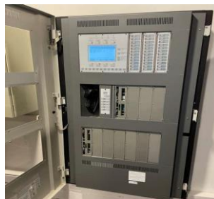
CENTRAL DE INCENDIOS
