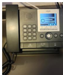
CITOFONO SALA DE CONTROL
